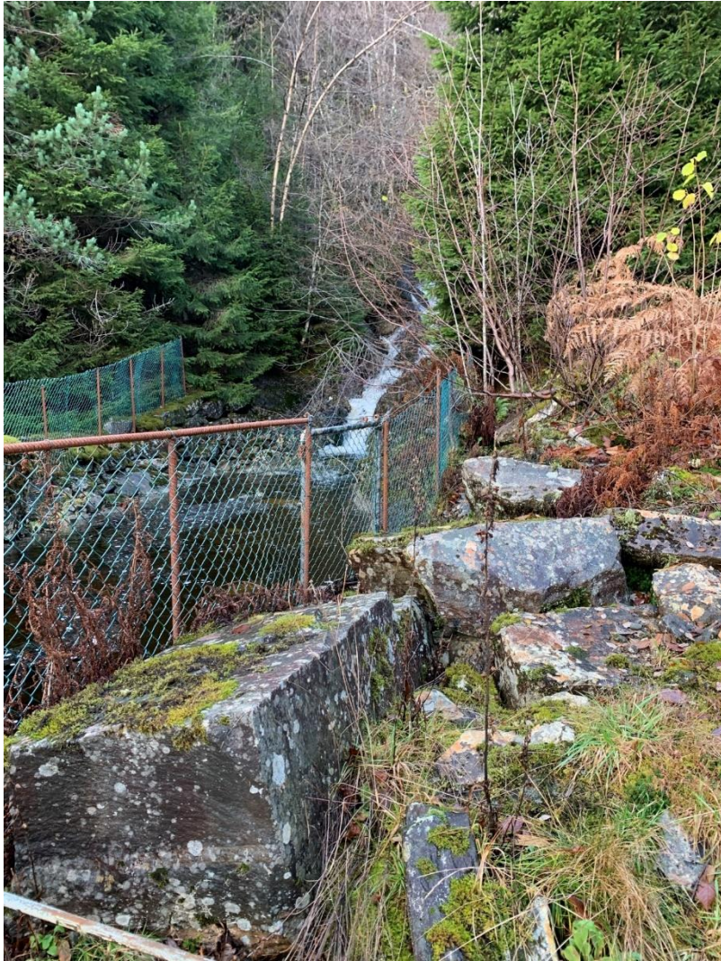
FIGUR 13: INNTAKSDAM OG VASSKJELDE FOR LAVIK VASSVERK. HER FOTOGRAFERT ETTER KRAFTIG NEDBØRSPERIODE. VASSTRAUMEN ER LIKEVEL LITEN.
