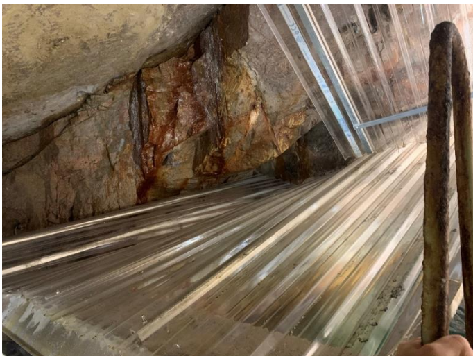
FIGUR 11: OMRÅDE MED STOR INNLEKKING I HB HØGREINA. PLASTSKJERMAR ER SETT INN SOM AVBØTANDE TILTAK.
