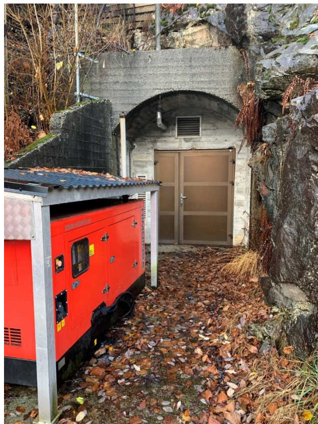
FIGUR 9: INNGANG TIL VASSBEHANDLINGS- ANLEGG I HØYANGER, NAUDSTRAUMS- AGGREGAT I FORGRUNNEN.
